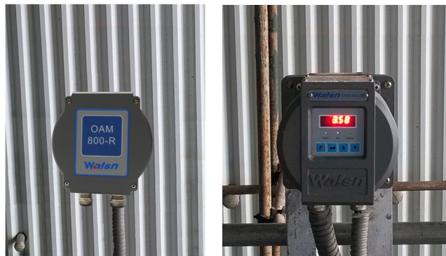
OAM-800-R 现场照片
